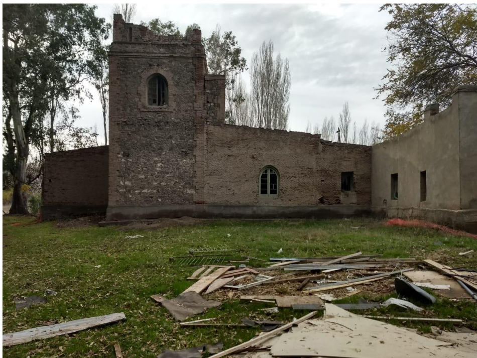
No se observaron trabajos de limpieza inicial de obra. (Fotografía tomada el 5 de junio de 2019).
